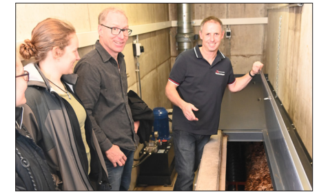
Roger Hegetschweiler ermöglicht einen Blick in den Silo der Holz-schnitzel in der neuen Heizanlage des Schulhauses Chappelstein.
