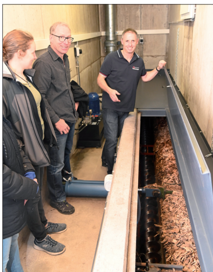
Silo der Holzschnitzel in der Heizanlage des Schulhauses Chappelstein
